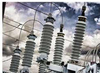
TRẠM BIẾN ÁP
