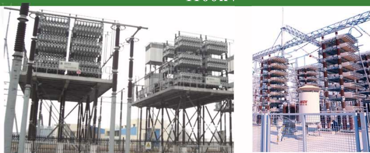
Giàn tụ bù (Shunt, Series, HVDC) cao thế 1100kV
