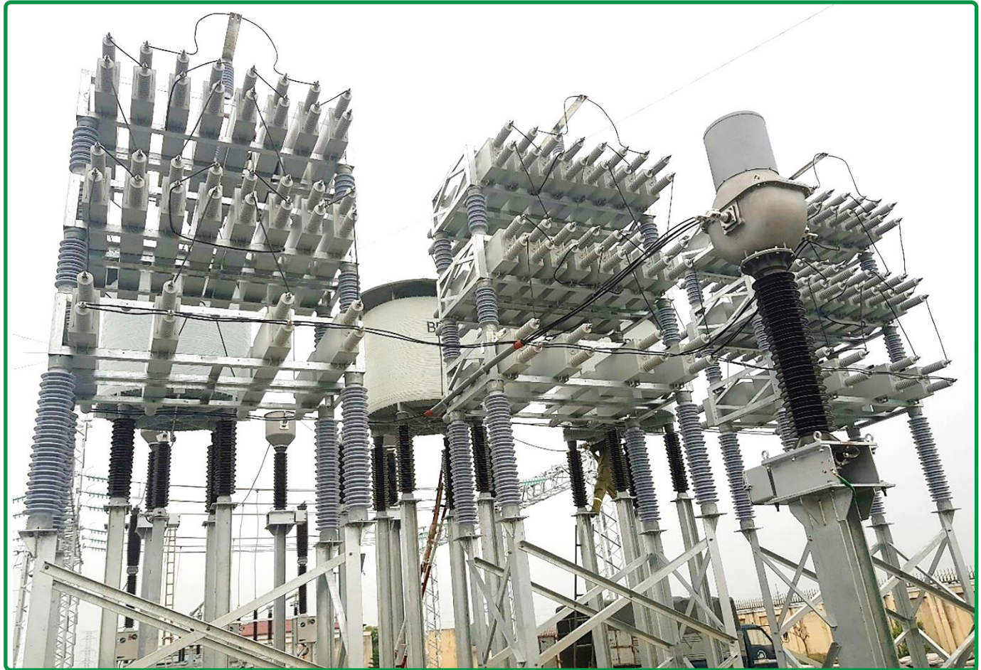
Giàn tụ bù cao thế (110kV, 220kV và 500kV)
