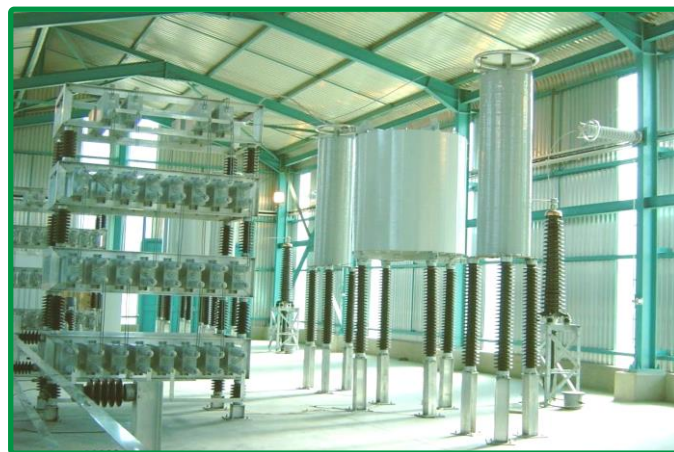
Giàn tụ bù trung thế 24kV và 35kV
